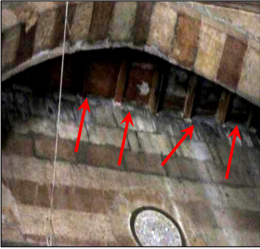
صورة رقم (١٤) : تزهر الأملاح علي سطح الحجر نتيجة لتأثير مياه الأمطار المتسربة نتيجة انفصال السقف عن الجدار (الواجهة الشمالية الغربية - جامع الرفاعي).
