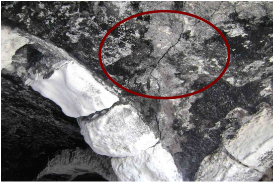
(لوحة رقم ١٢) توضح وجود شروخ في السقف وطبقات سناج كثيفة.
