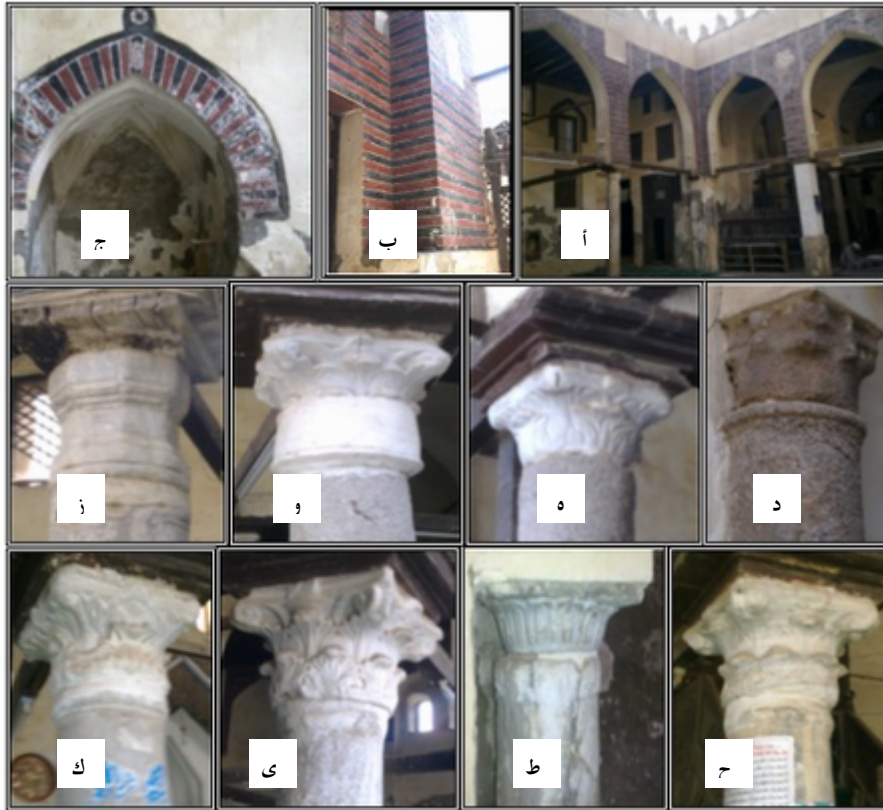
لوحة (٣) نماذج لزخارف الطوب المنجور والتيجان الجرانيتية والرخامية المختلفة في الشكل والحجم علي الأعمدة الجرانيتية والرخامية بمسجد البجم ويظهر بها مظاهر التلف المختلفة.
